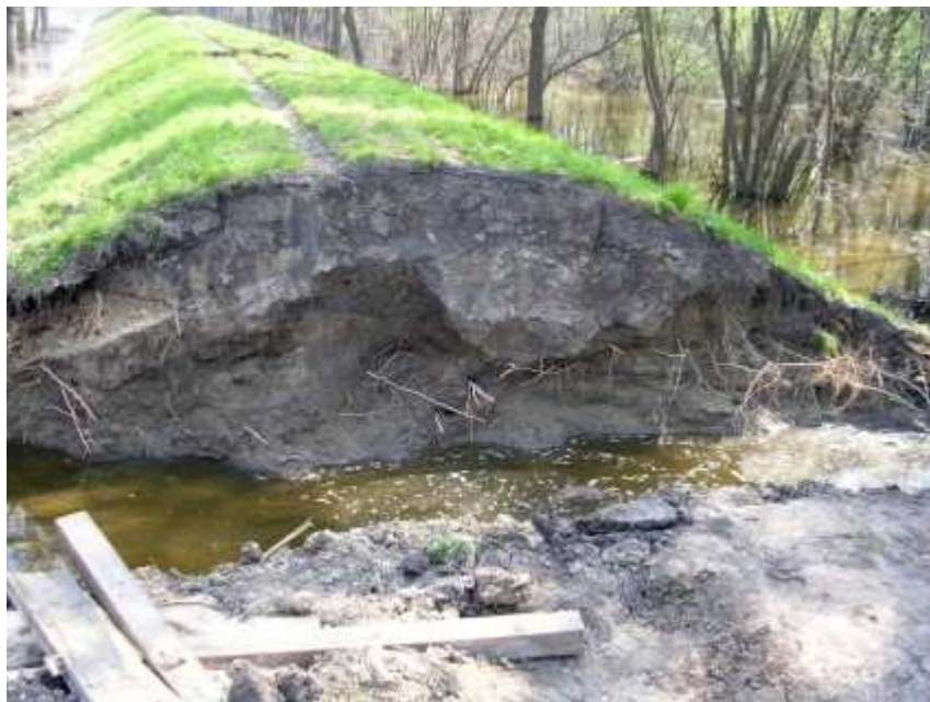
...weiter südlich wurde der Damm künstlich geöffnet, damit das Wasser wieder abfließen konnte
