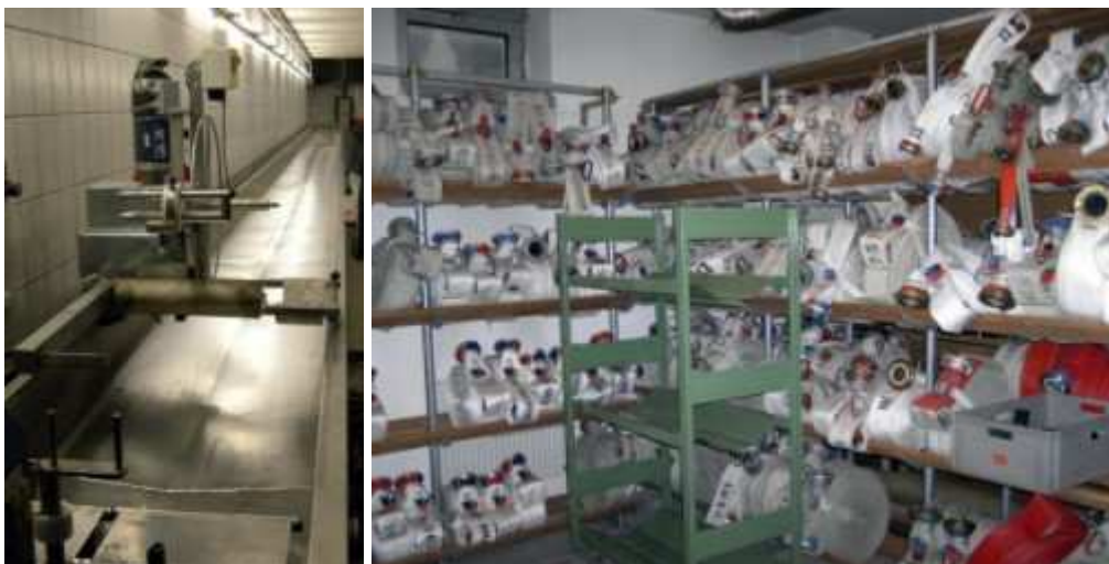
...Schlauchwaschanlage und Schlauchlager
