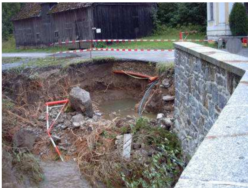
Die Auswaschung eines Brückenwiderlagers bei der Kampbrücke erfordert nun eine Sperre für LKW
