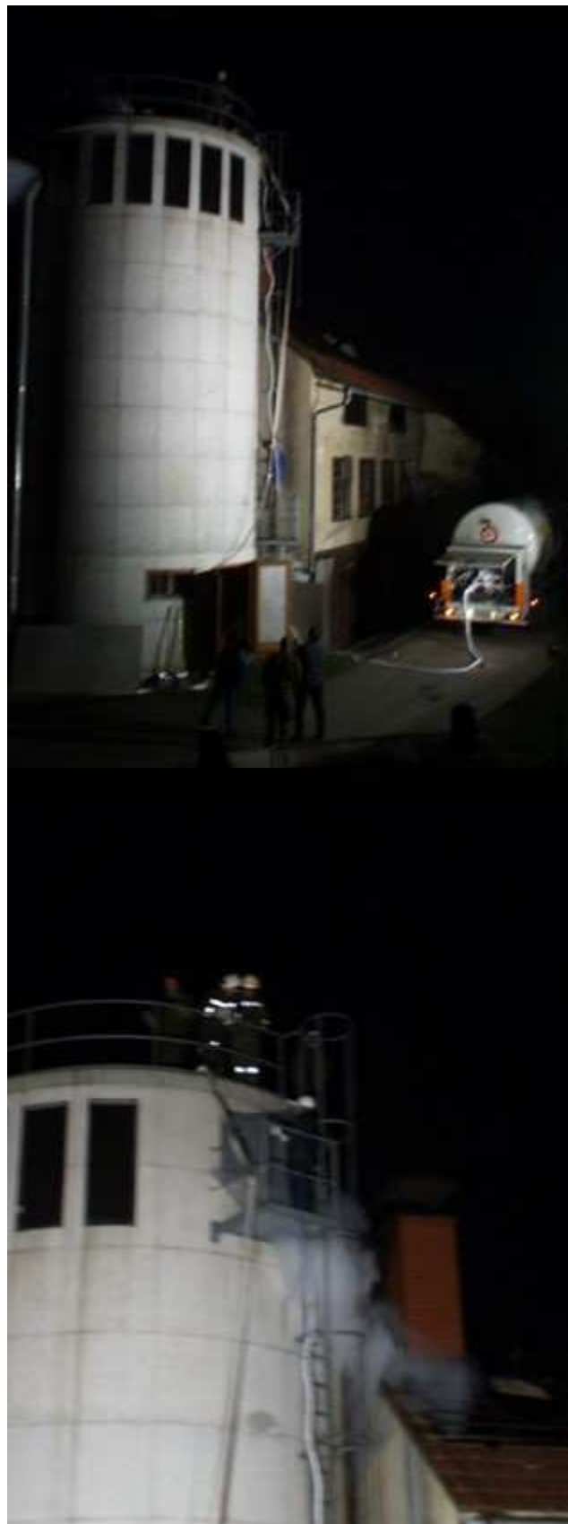
Der flüssige Stickstoff wird in den Silo eingebracht
