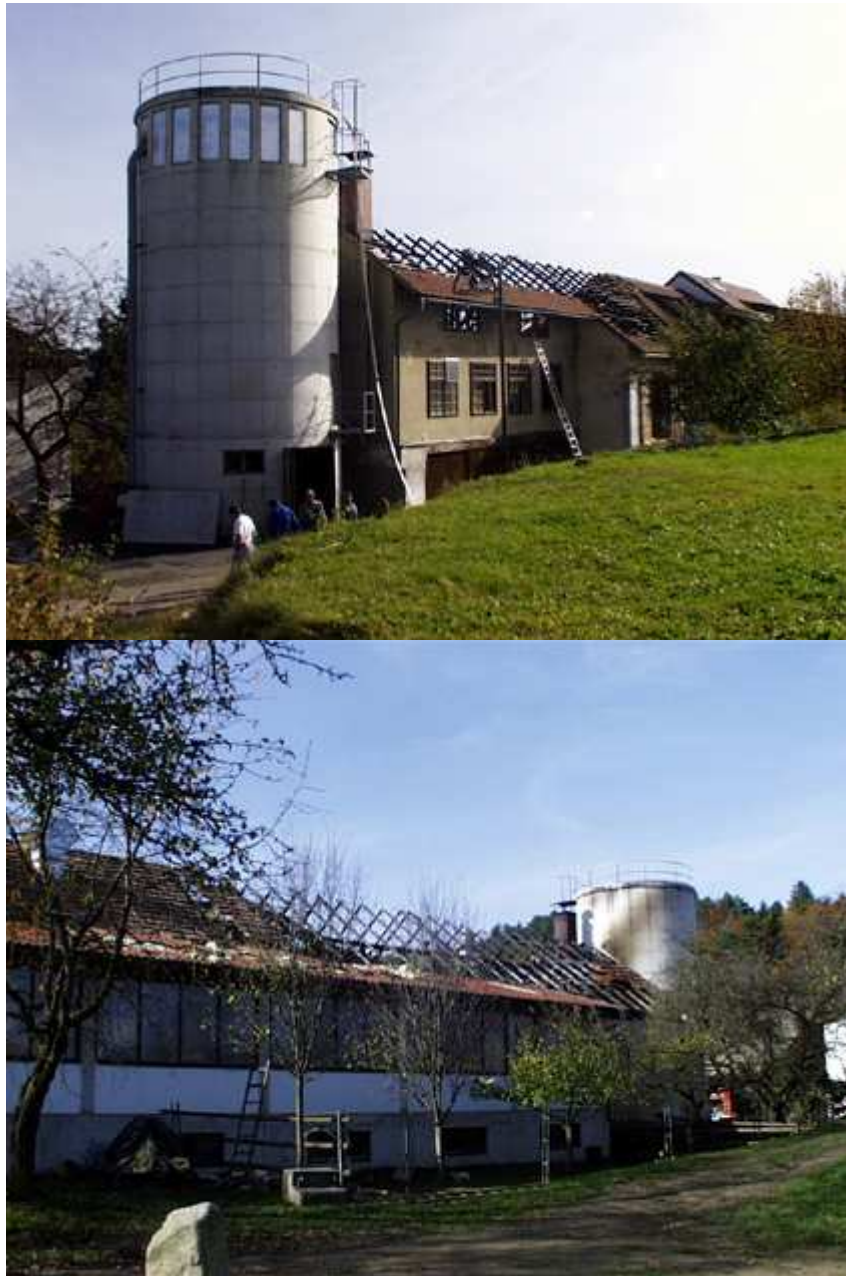
Der total ausgebrannte Dachboden
