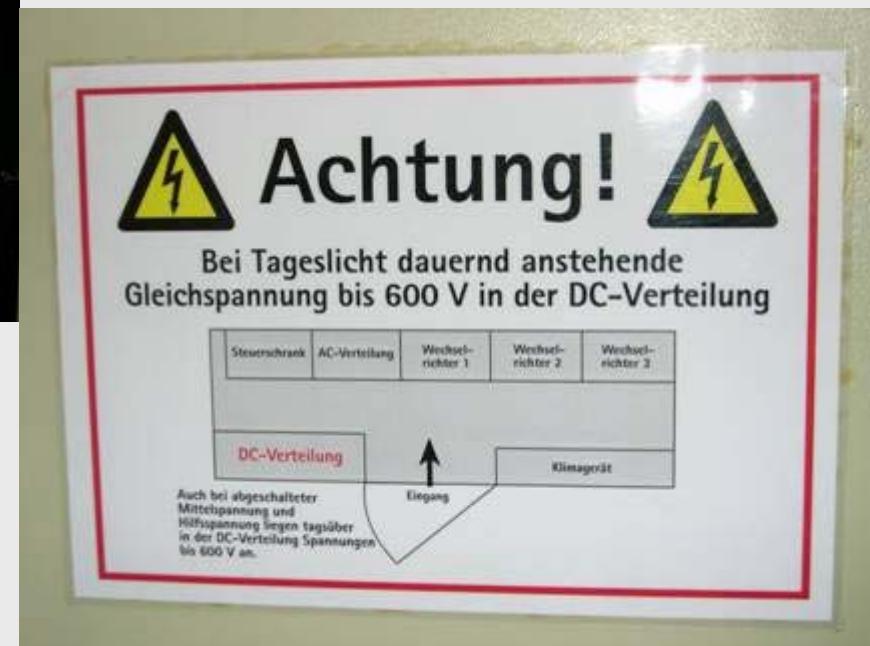
Sicherheitshinweis am Schaltschrank
