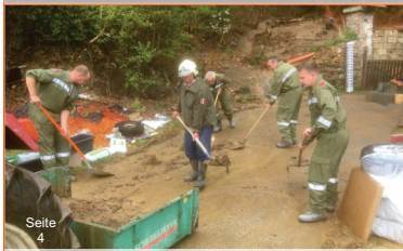
Seite 4 FF Thaua: Aufräumarbeiten nach Hangrutsch (Mai 2022)
